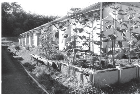
住棟間の土留めのベニアが傾いている (細根沢団地)
