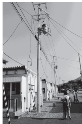
ソケットが落下した電柱
