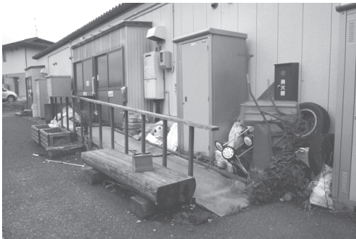
老朽化した玄関前のスロープ（二日市団地）
