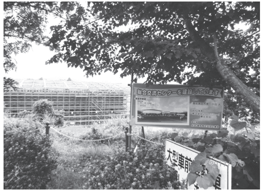
仮設団地の東側に総合交流センターを建設中 (長砂団地)
