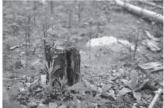
解体撤去後の基礎杭は腐食が進んでいた (中上団地)
