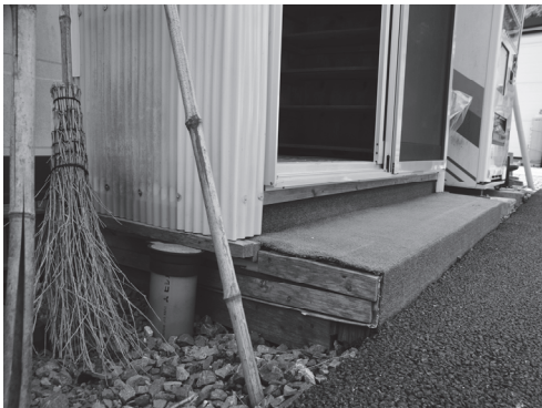
仮設住宅の老朽化が進んでいる (矢作町)
